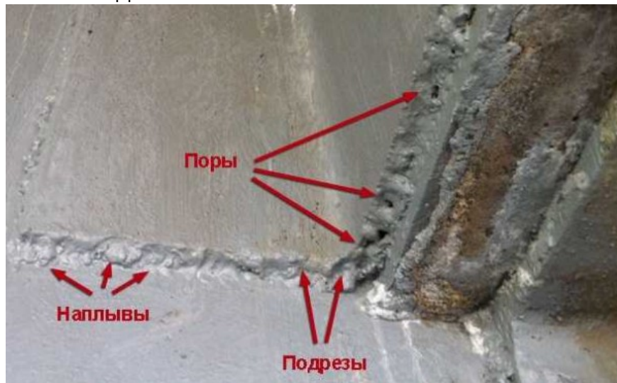
Основные дефекты сварных швов
